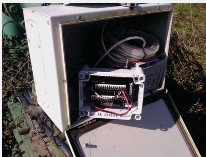
Equipamiento medición automática del nivel.
